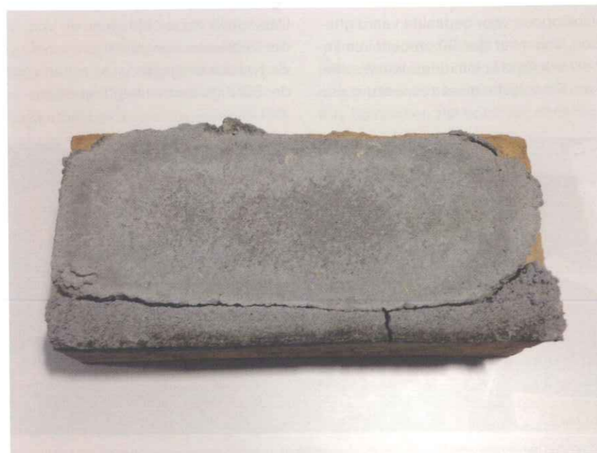
Een baksteen uit niet vol en zat metselwerk, met losgekomen voegwerk en uitslag.
