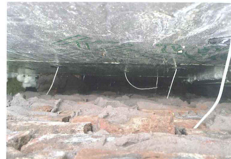
Een regelmatig voorkomend probleem: als het niet goed uitkomt, dan buigen we de spouwankers toch gewoon om?
