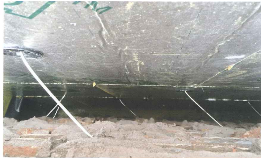
Te lange spouwankers die schuin worden geplaatst en zo niet meer kunnen functioneren.
