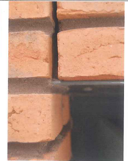
Verkeerd uitgevoerde oplegging van een stalen latei in de mortel. Die had glijdend moeten zijn.
