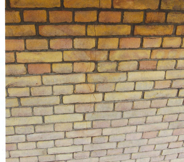
Scheurvorming in gevelmetselwerk uit de jaren twintig.
