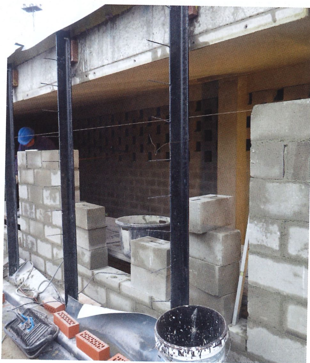
Ook op dit voorbeeld een onjuiste uitvoering van op de staalconstructie gelaste spouwankers.
