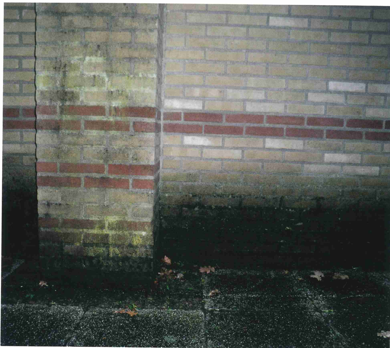
De plint is een kritisch detail nu die niet meer zoals vroeger wordt uitgevoerd met trasraamklinkers.
