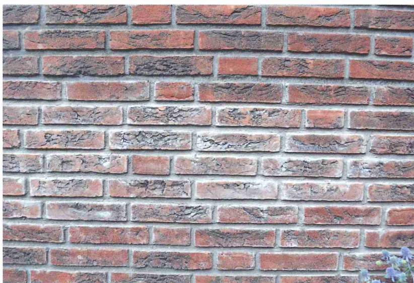
Smet op gevelmetselwerk dient ook niet voor te komen en moet op vakkundige wijze worden verwijderd.
