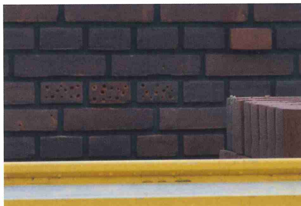
Geboorde insectengaten in bakstenen bij de Amstelstroombrug te Amsterdam.
